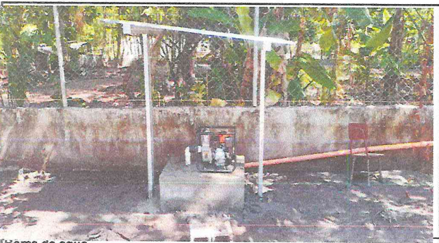
Bomba de agua
